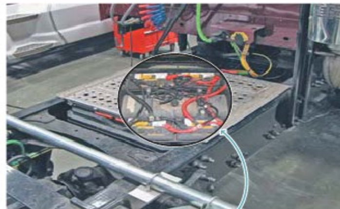
Derrière la cabine
